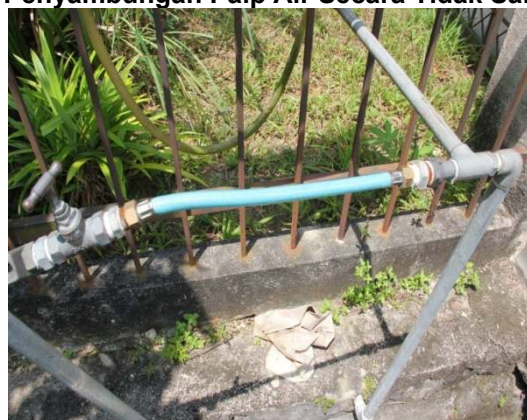
Gambar 4.8 Penyambungan Paip Air Secara Tidak Sah
