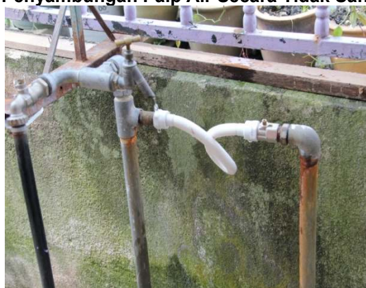
Gambar 4.7 Penyambungan Paip Air Secara Tidak Sah
